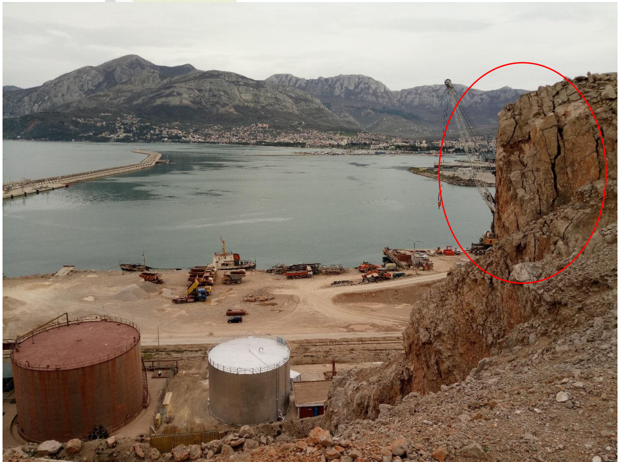
Slika 1 - Rastreseni nestabilni stijenski blok ispod kojeg se nalaze rezervoari
